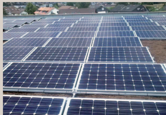
Installation photovoltaïque sur le toit du nouvel immeuble de Therwil (surface modulaire de 380 m 2 et une puissance de pointe de 59 kWp).
