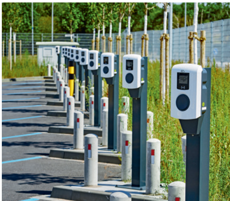
Berlin, Dahlewitz (station de recharge de véhicules électriques)
